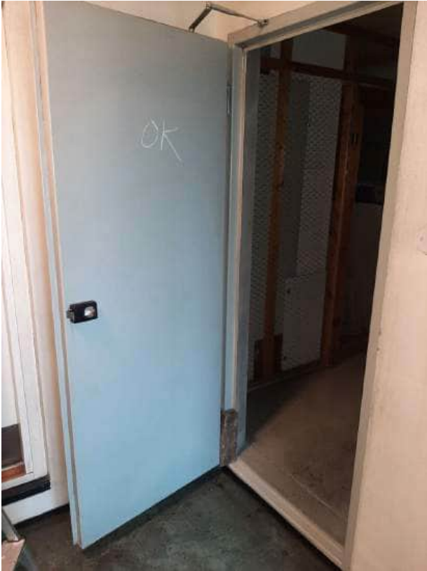
Yleiskuvia rappukäytävän nokivaurioista 8krs
