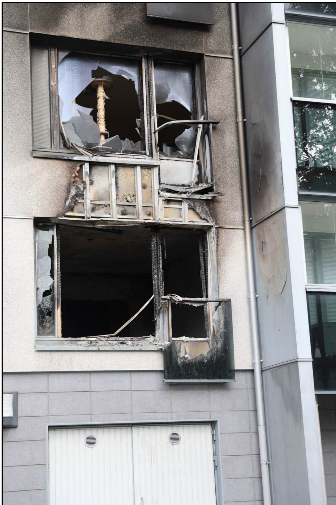
4. Lähikuvat rikki menneistä ikkunoista. Alimpana 24 A 4 asunto.
