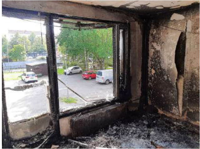
As4 ikkuna tuhoutunut karmeineen
