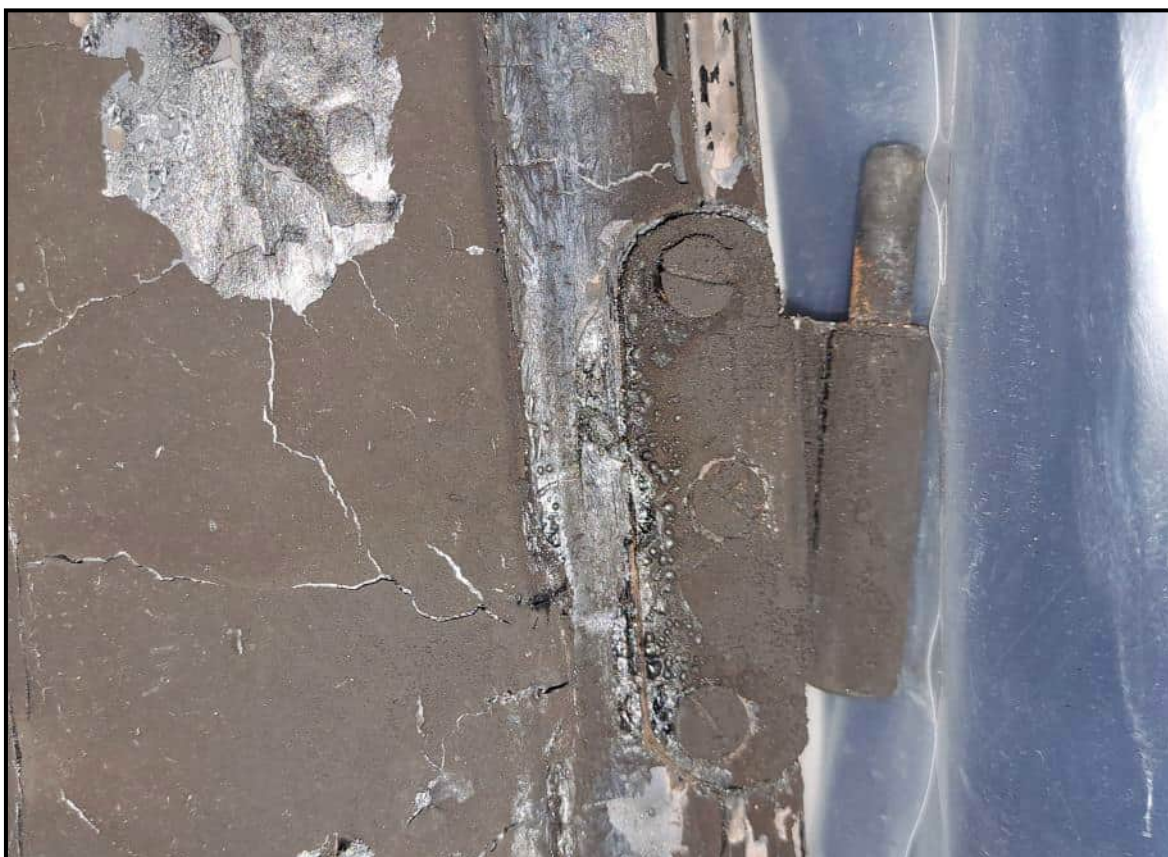
13. Lähikuva ovenkarmin yläpuolella kiinni olleesta ulko-oven saranatapistä (kuvassa 12 nähtävissä oikealla)
