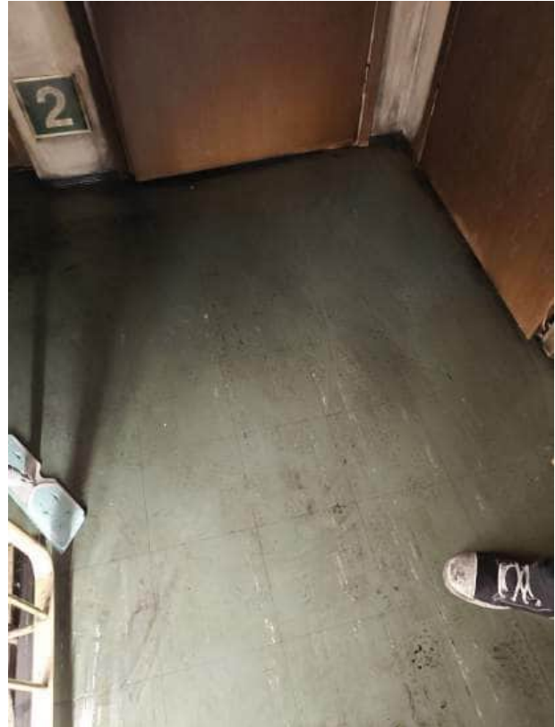
2 krs lattiapinnoiteen pinnassa muodonmuutoksia.
