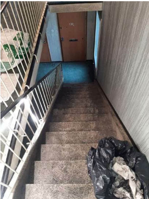
Yleiskuvia rappukäytävän nokivaurioista 8-7krs portaat
