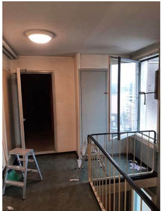
Yleiskuvia rappukäytävän nokivaurioista 8krs
