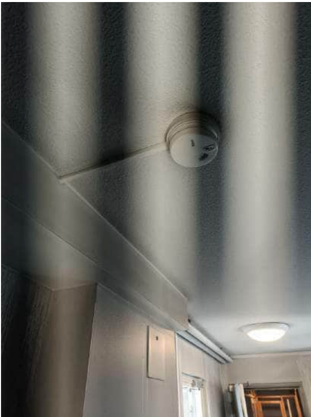
Ullakkokerros, käytävän palohälytin
