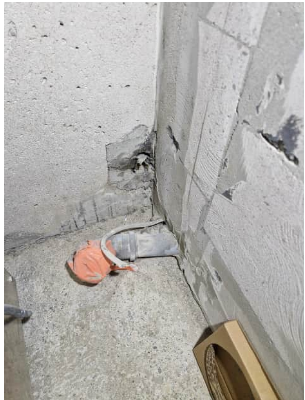
Kuva 4. Huoneisto 4, keittiön viemäri.
