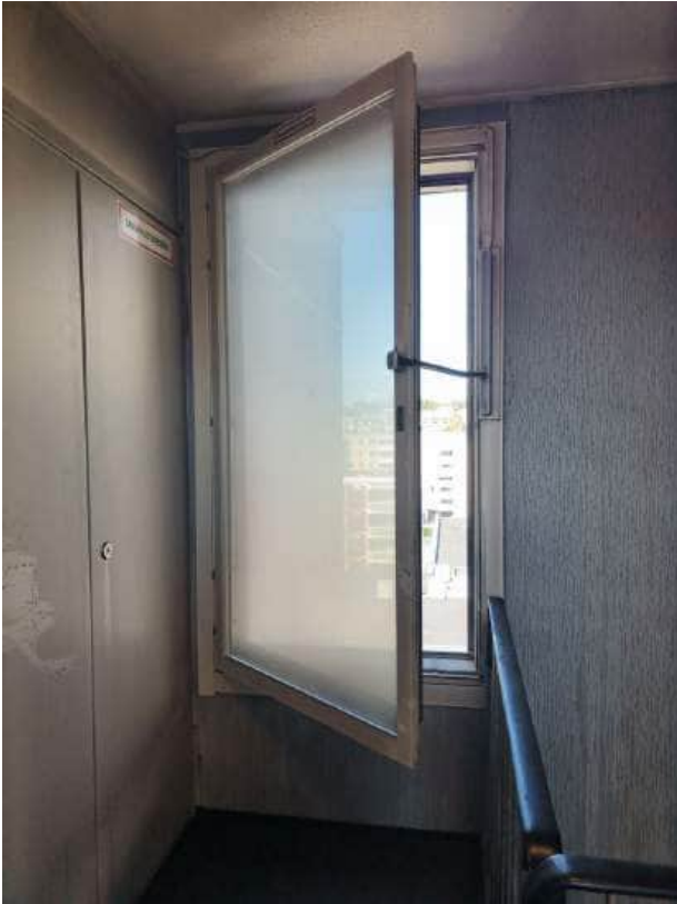
Ullakko yleiset porrashuoneen savunpoisto
