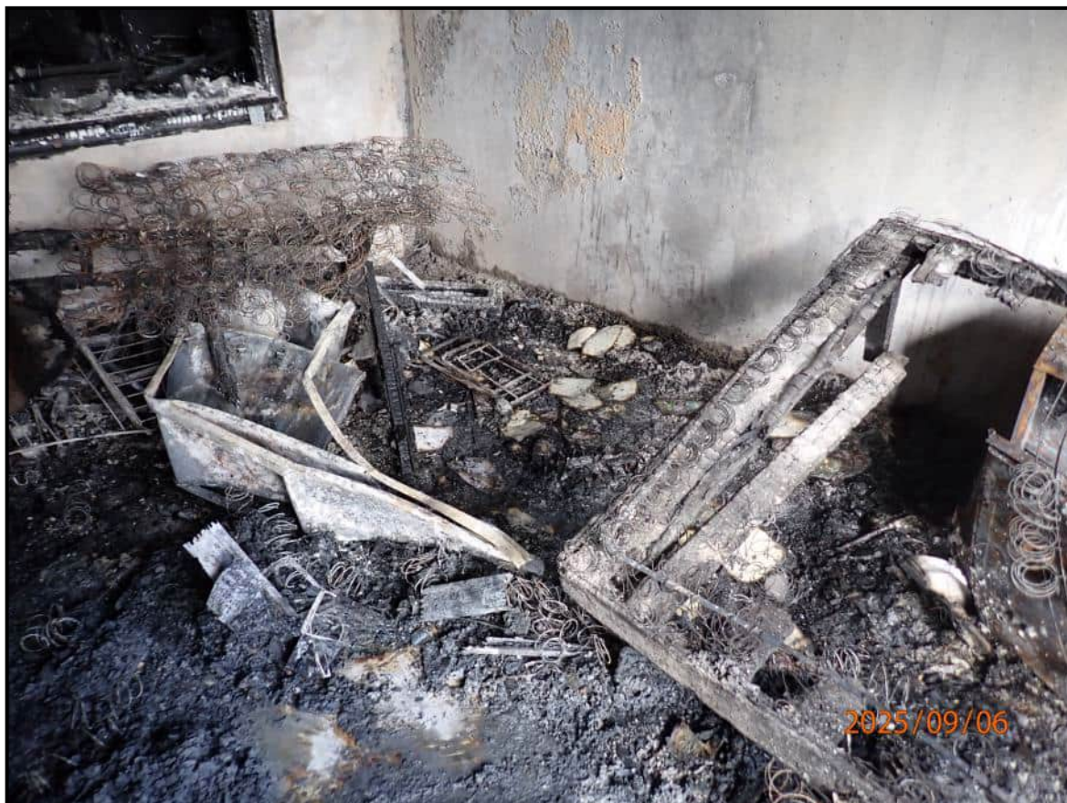
21. Asunnon olohuoneen lattialla ollutta palanutta omaisuutta.
