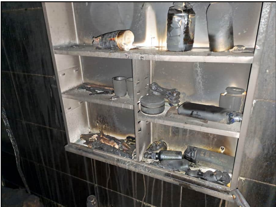
29. Kuva kylpyhuoneen peilikaapin sisällöstä.
