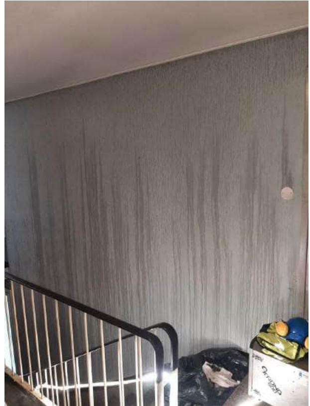
Yleiskuvia rappukäytävän nokivaurioista 8krs
