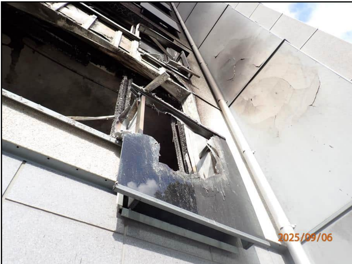
6. Vauriot kuvattuna 24 A 4 asunnon alapuolelta.
