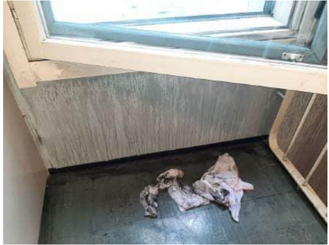
Yleiskuvia rappukäytävän nokivaurioista 8krs
