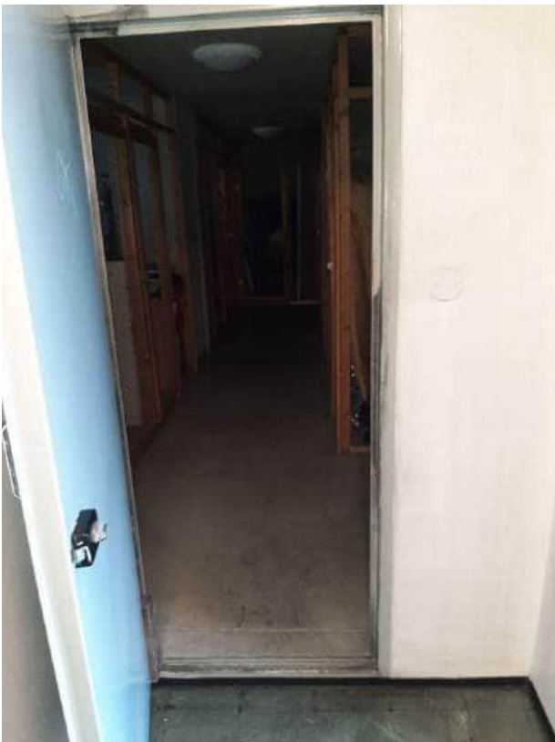
Yleiskuvia rappukäytävän nokivaurioista 8krs
