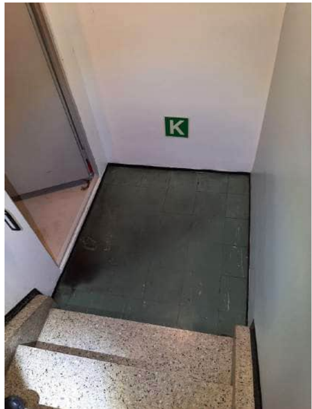
Kellari sammutusvesiä ollut lattialla
