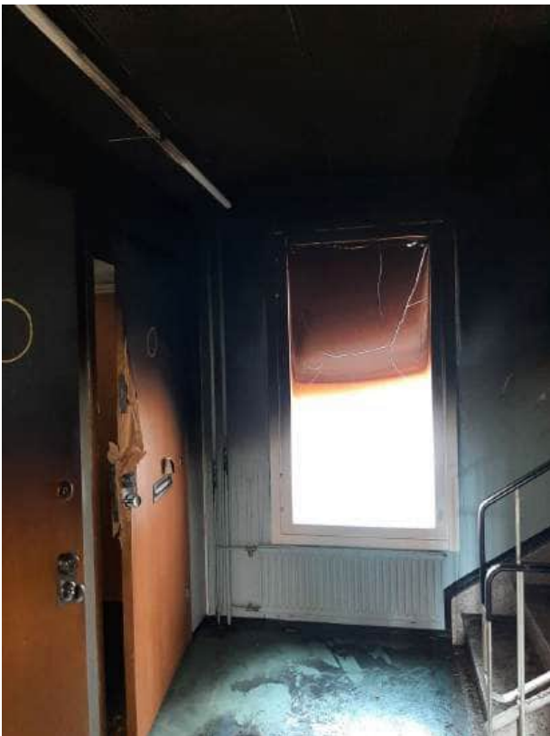
1 krs, rappukäytävän ikkuna rikki. Asuntojen ulko- ovista menty eri tavoin sisään
