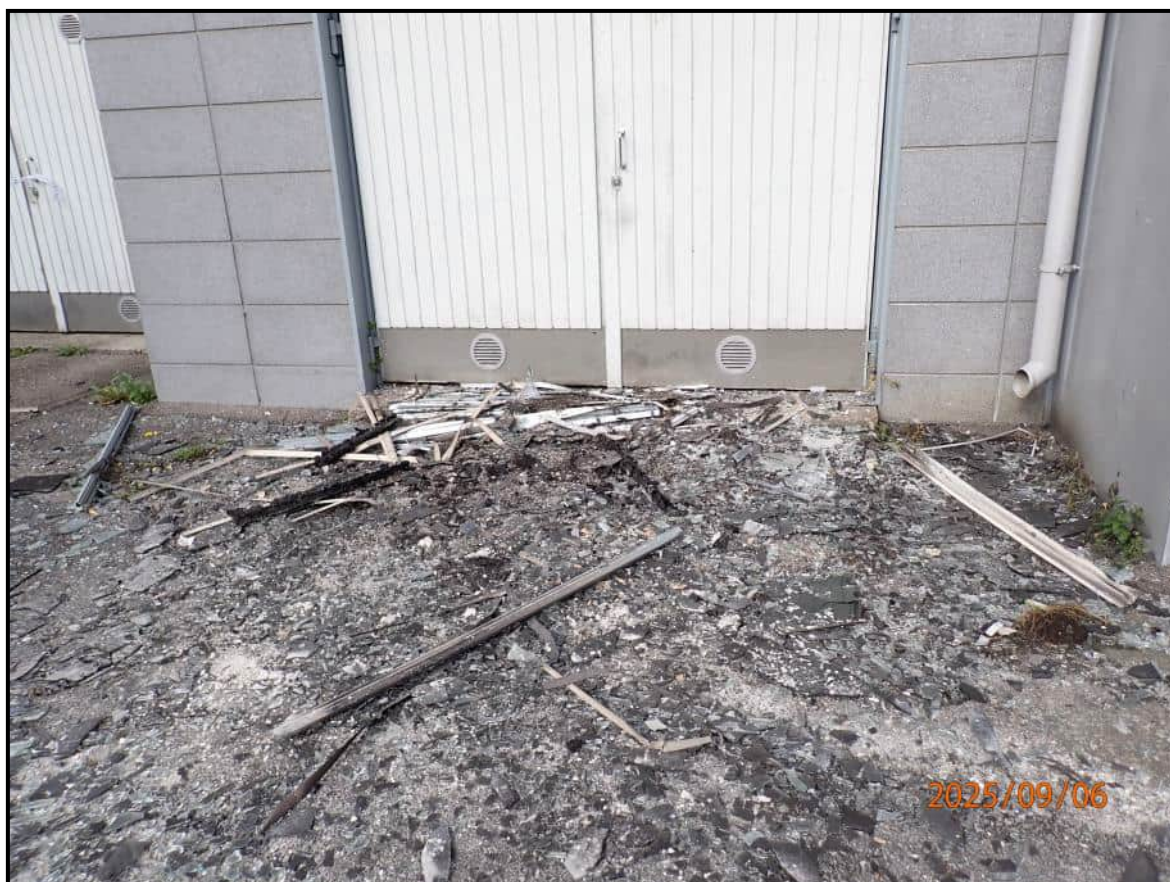
2. Kullervonkatu 24 A 4 asunnon alapuolella olevia lasinsiruja ym palojätettä.
