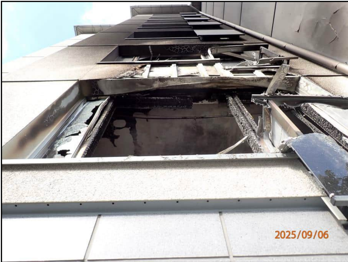
5. Kuvassa seitsemän kerroksisen kerrostalon vauriot kuvattuna 24 A 4 asunnon alapuolelta.
