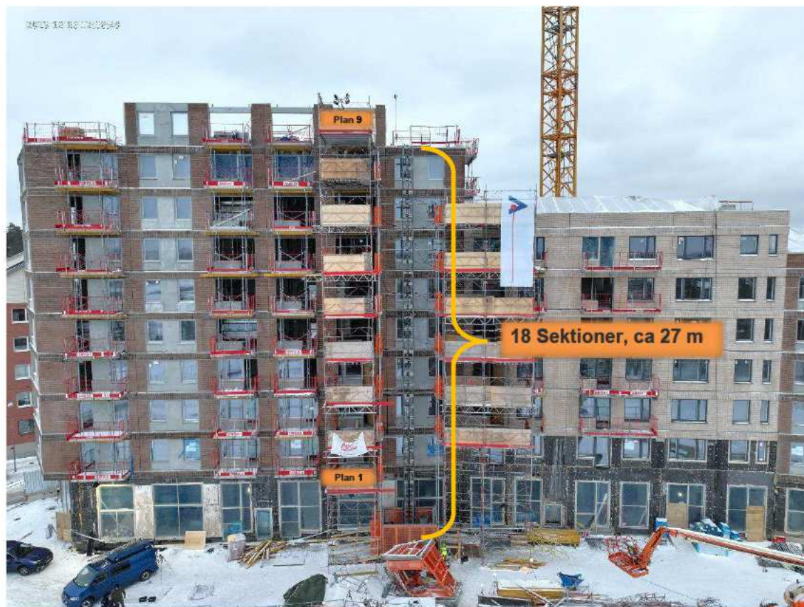
Figur 4. Översikt över byggarbetsplatsen. Hissen ligger framför masten och hisschaktet. Sammanlagt 18 sektioner, ca 27 m av masten är fortfarande kvar.
