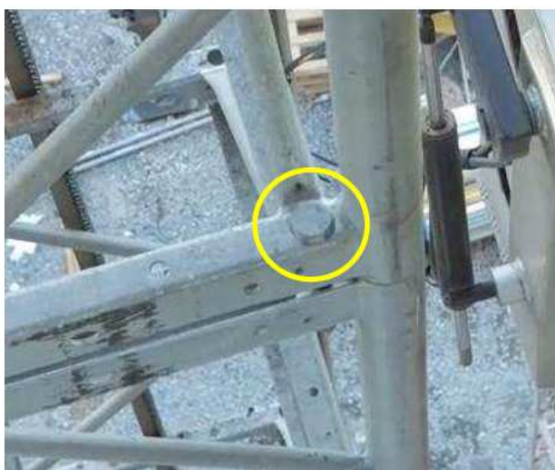
Figur 29. Ett skruvförband på mastskarven mellan sektion 10 och 11 var felmonterat.
