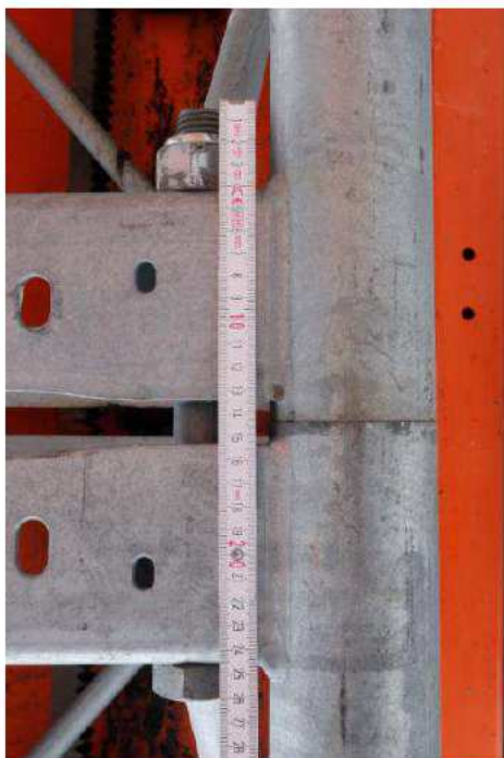
Figur 27. Skruvförband korrekt monterad genom två mastsektioner.
