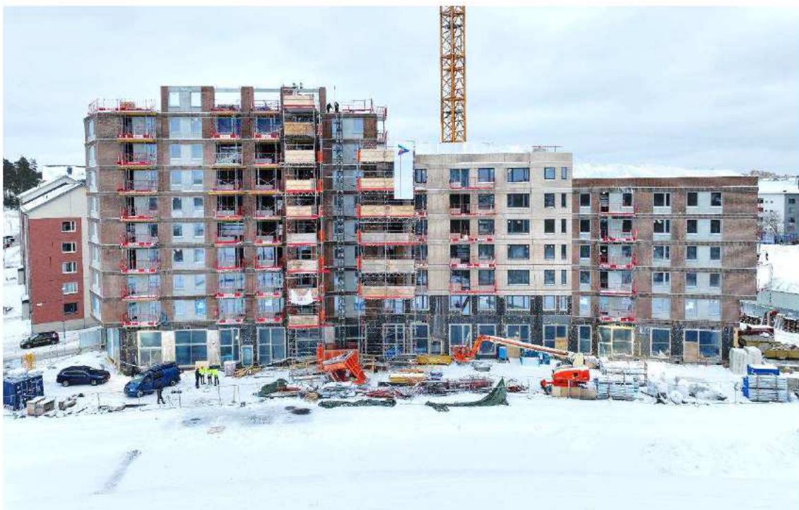
Figur 2. Översiktsbild över byggarbetsplatsen och de olika nivåerna av byggnationen. I mitten av bilden ses bygghissens korg ligga framför mastkonstruktionen.
