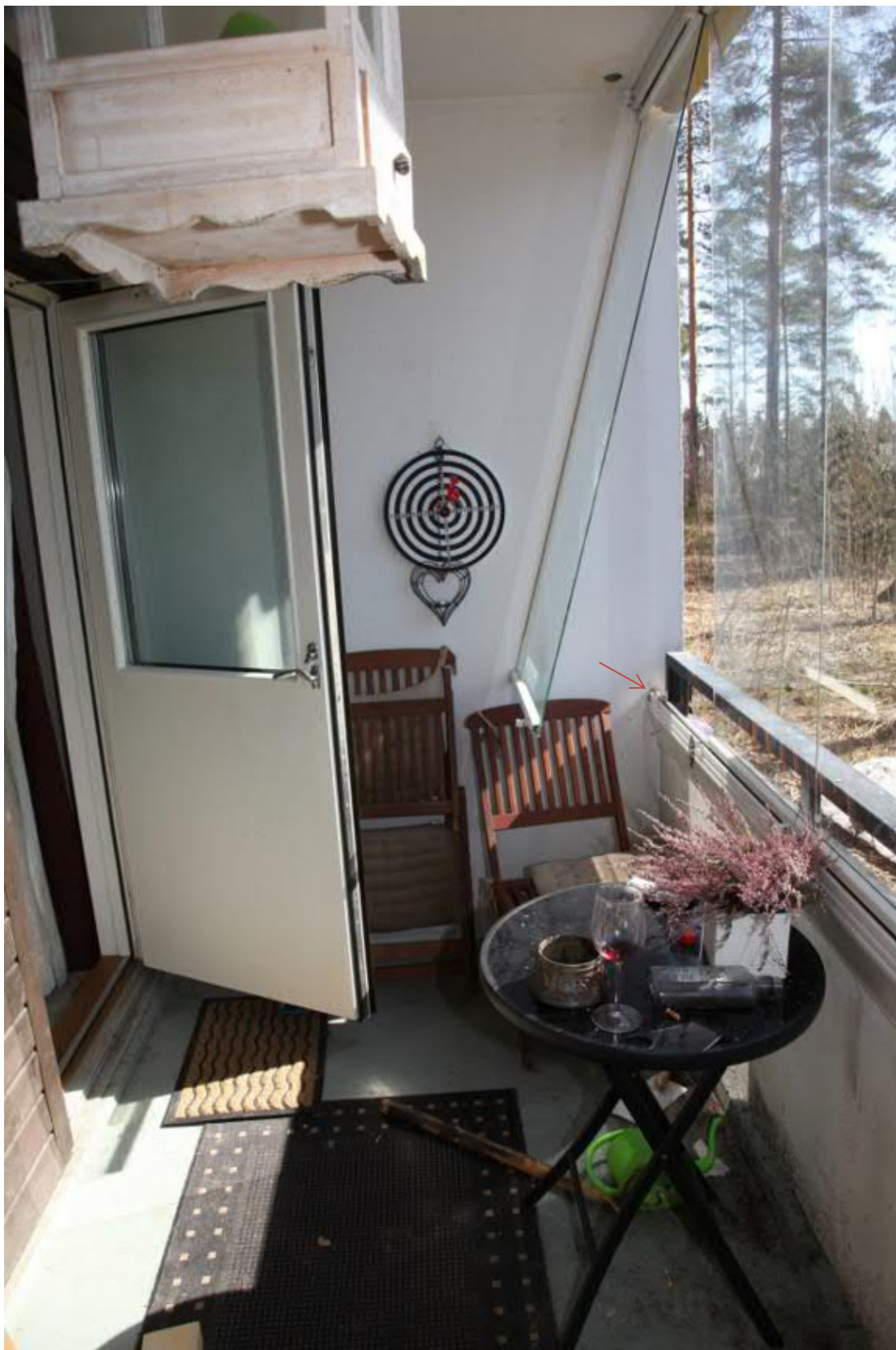
Kuvassa nuolella osoitettu kohta, on vaurioitunut parvekkeenlasin kiinnike, joka näkyy tarkemmin kohdan 28. kuvassa.
