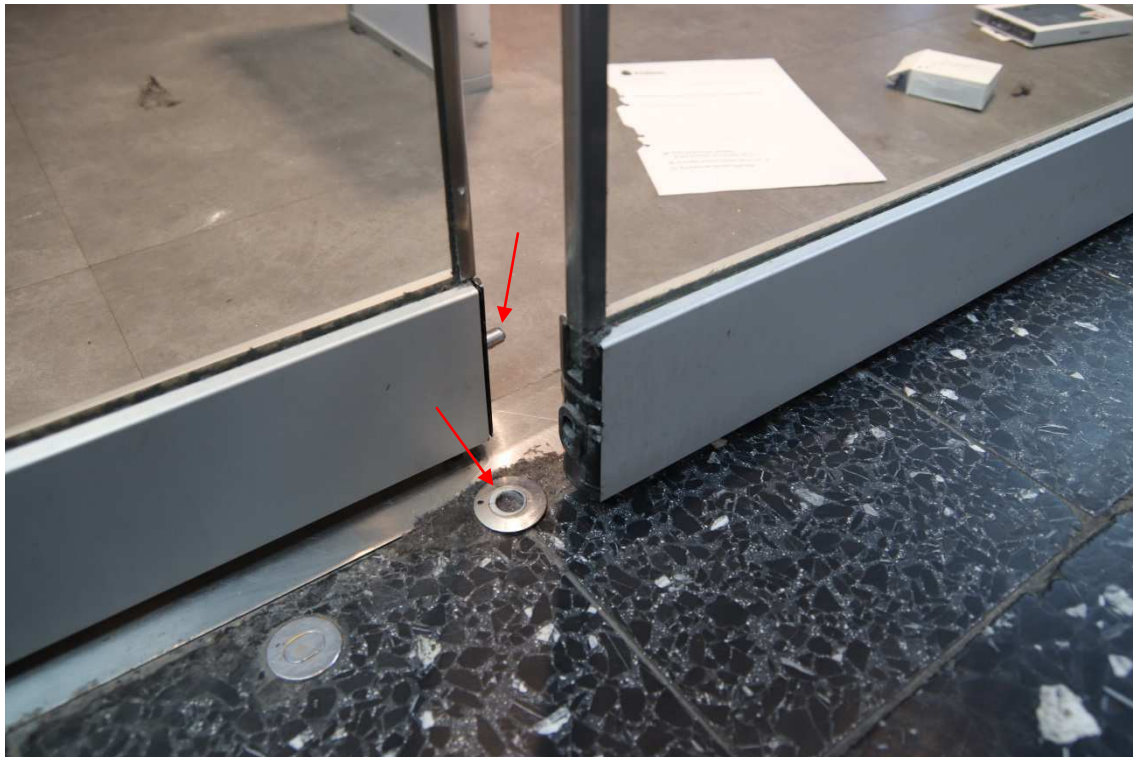
Figur 6. Del av nederdelen på dörr 3 och 4. Ett hål i golvet/ingjutningshylsan där rutan skall fästas med en metallpigg är markerat. En skjutregel som skall fästas i rutan bredvid är markerad, denna regel såg ut att vara snedställd. Bilderna är tagna efter att dörrarna öppnats för undersökningen.
