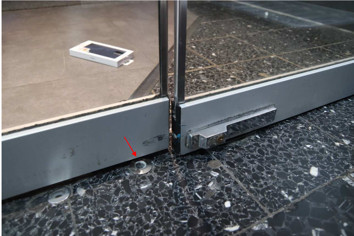
Figur 5. Del av nederdelen på dörr 5 och 6. Ett hål i golvet/ingjutningshylsan där rutan skall fästas med en skjutregel är markerat. Bilderna är tagna efter att dörrarna öppnats för undersökningen.
