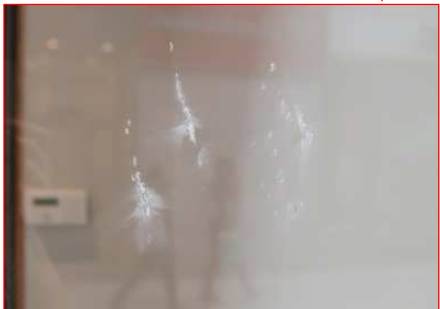
Figur 4. Skador i glaset på utsidan av dörr nr 6.
