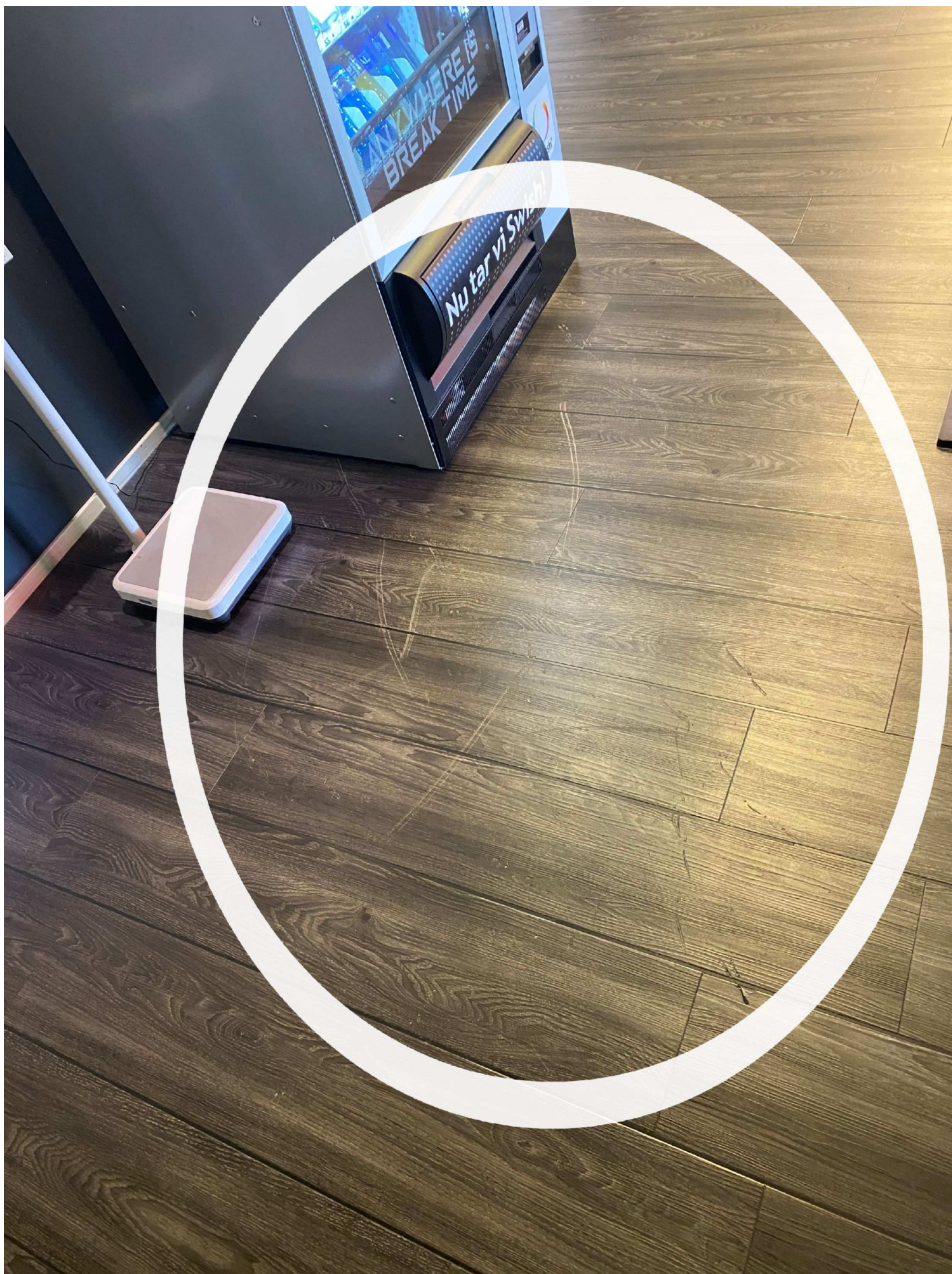
8. Skador på golv framför automaten
