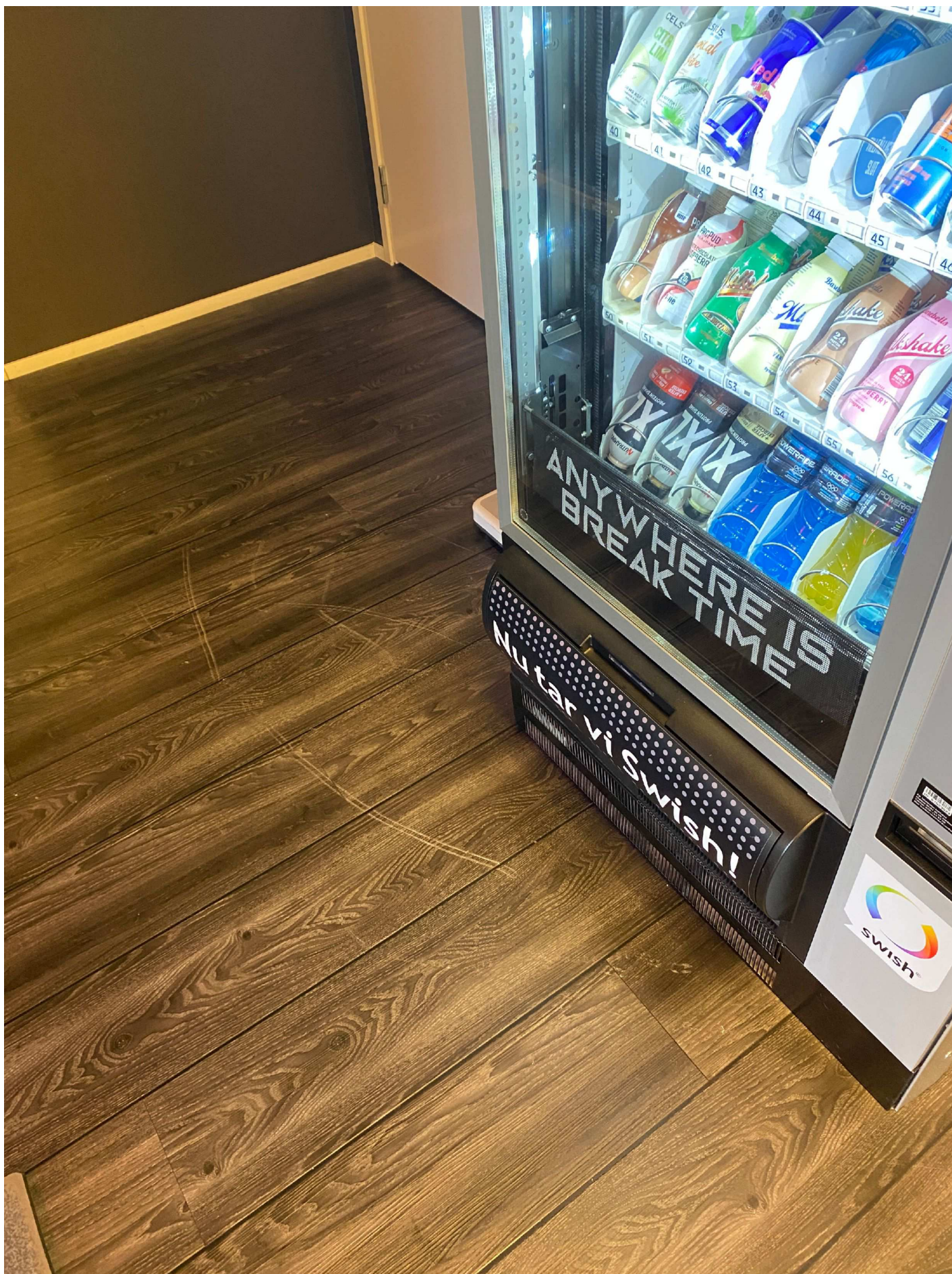
5. Skador på golv från automaten
