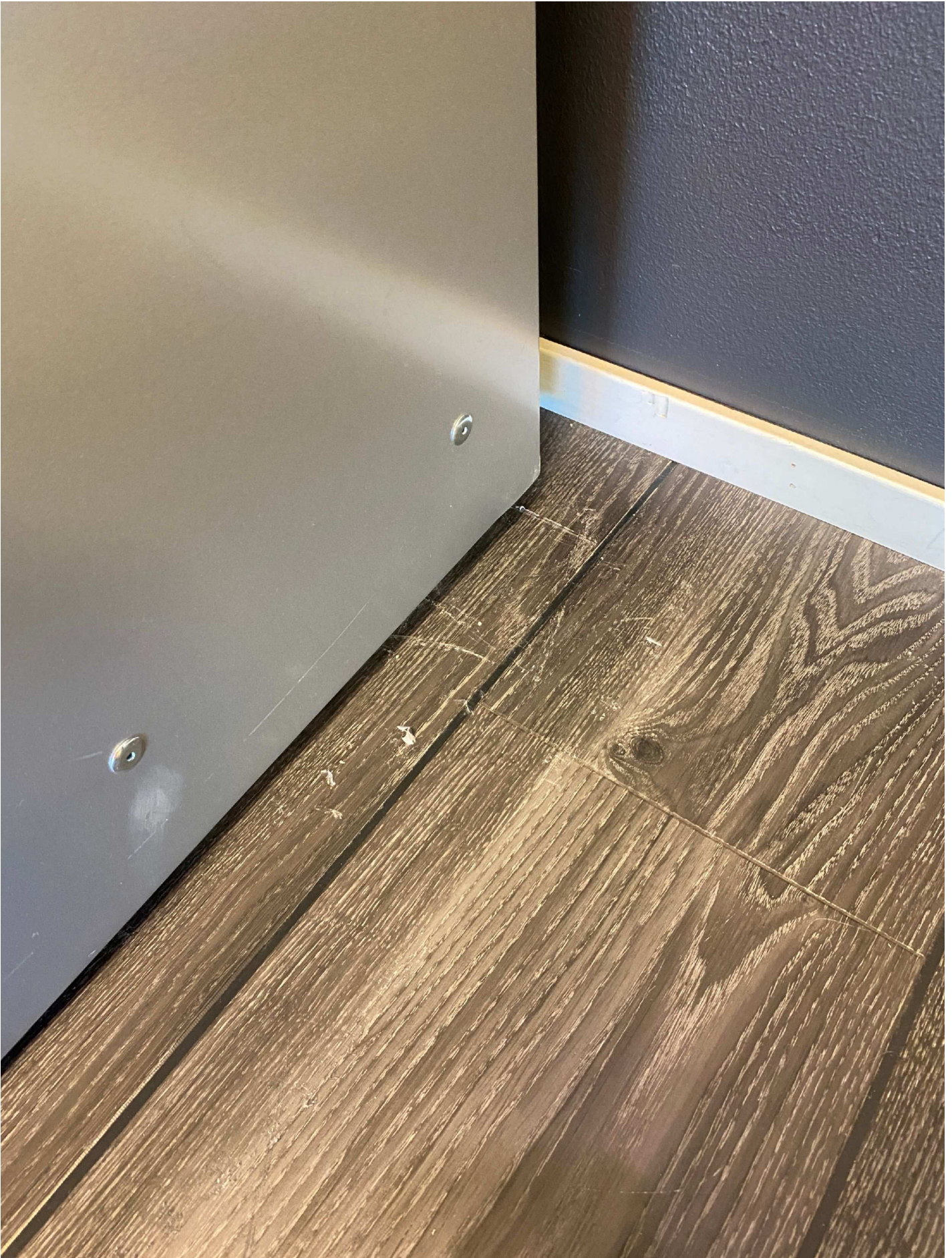
3. Repor på golvet på automatens högra sida
