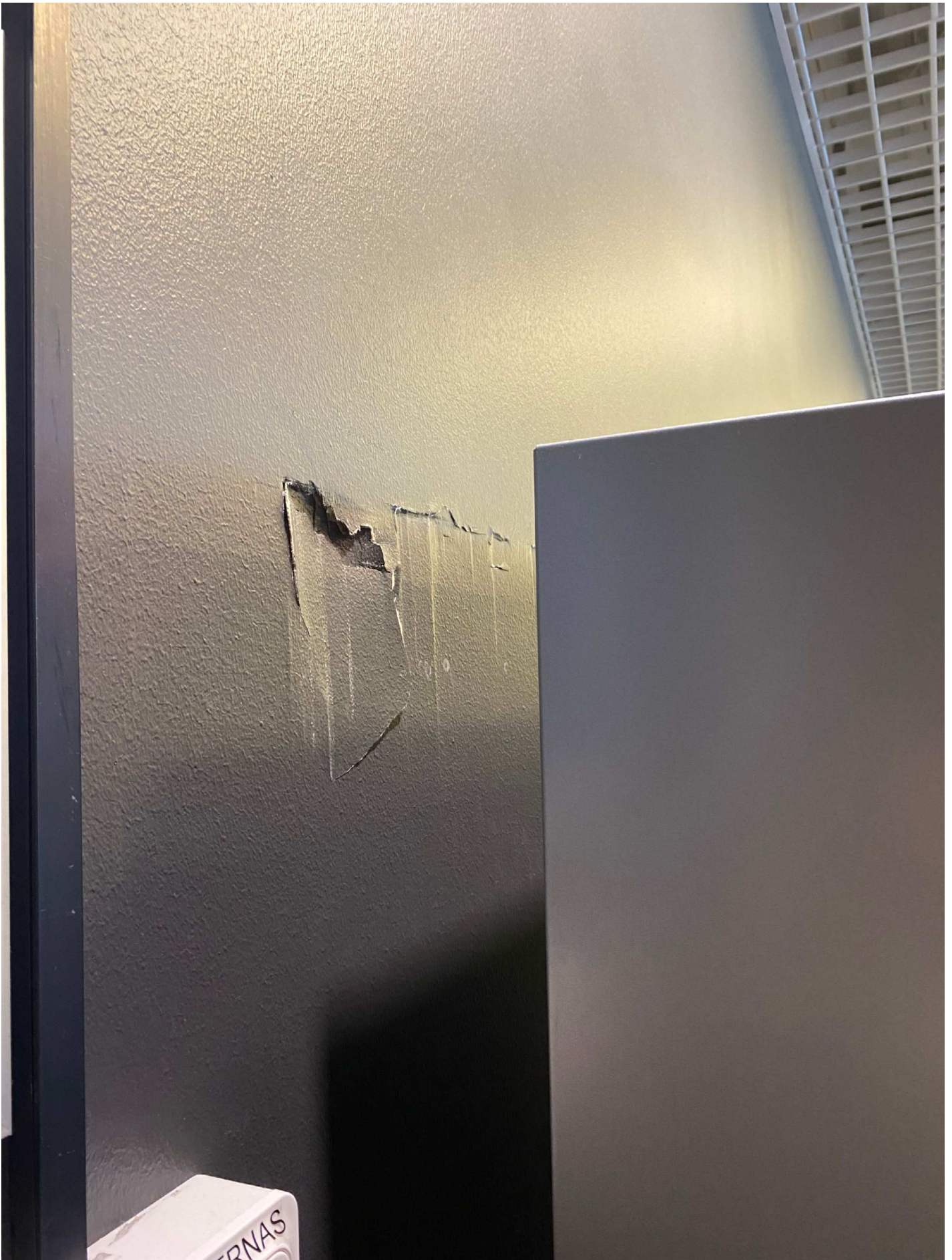
7. Skador på vägg bakom automaten, vänster sida
