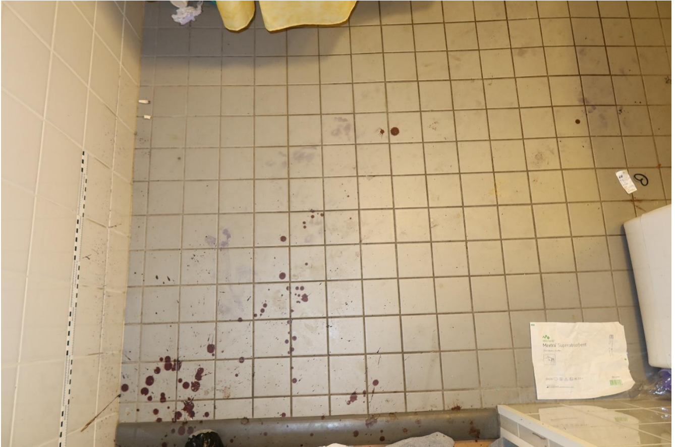
Kuva 12. Kuva wc-/suihkutilan lattian verijäljistä.
