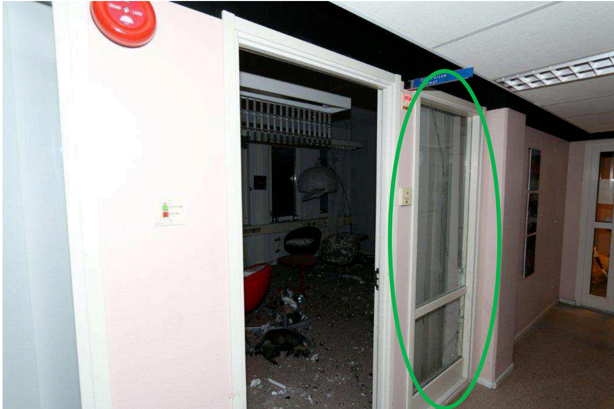
Bild 11 Visar exempel på verkan av handgranat av typ M50/M52 i byggnad.
