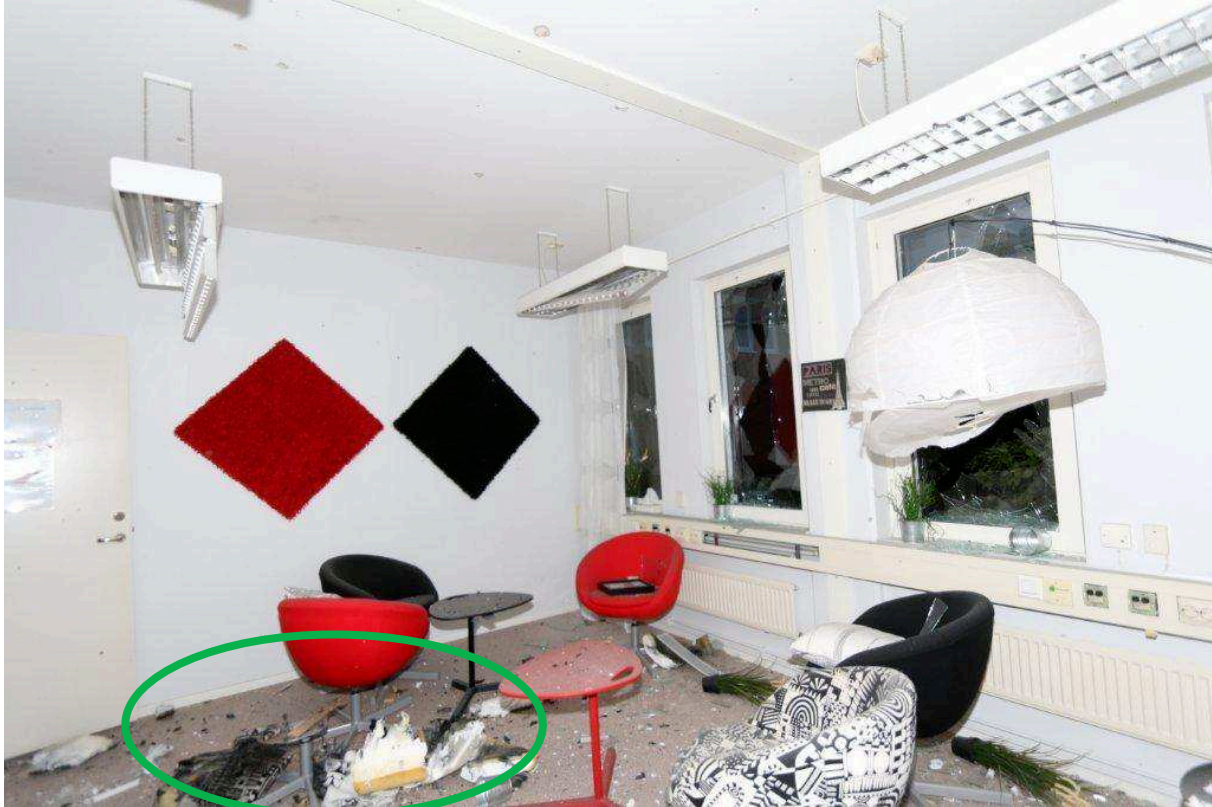
Bild 8 Visar exempel på verkan av handgranat av typ M50/M52 i byggnad.
