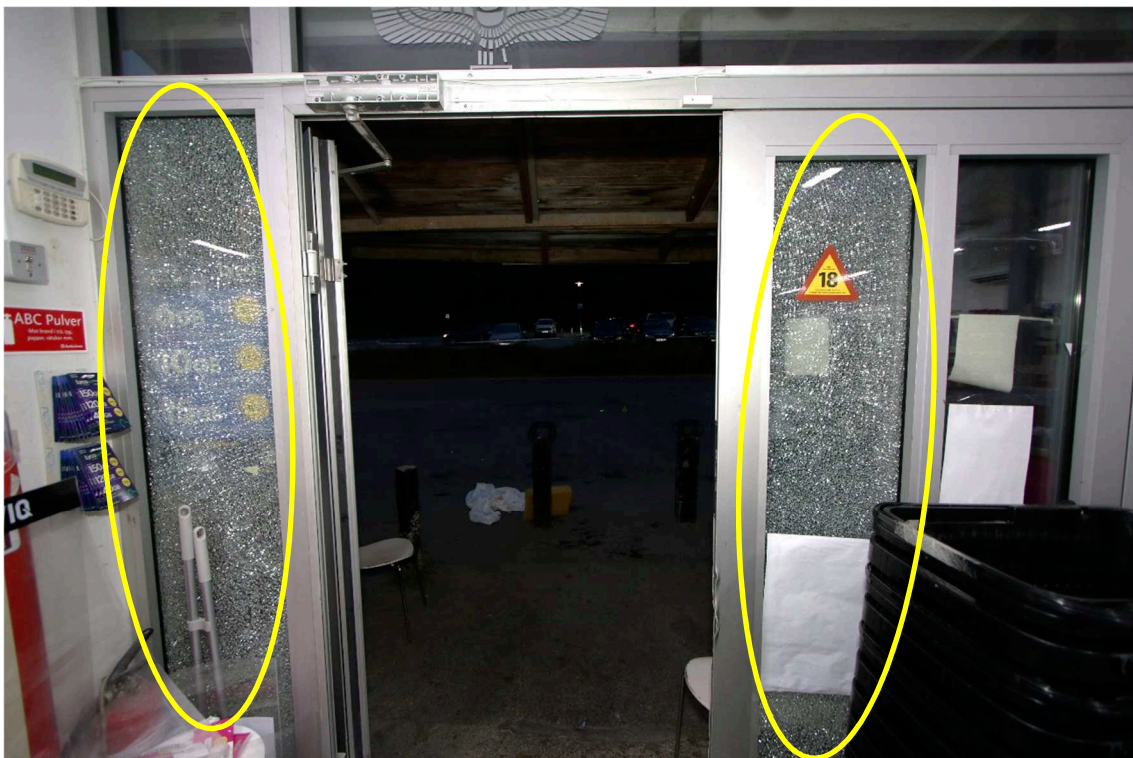
Figur 7: Entré. Bild tagen ut mot den asfalterade ytan framför butiken. Krackelerade rutor markerade med gula ringar.
