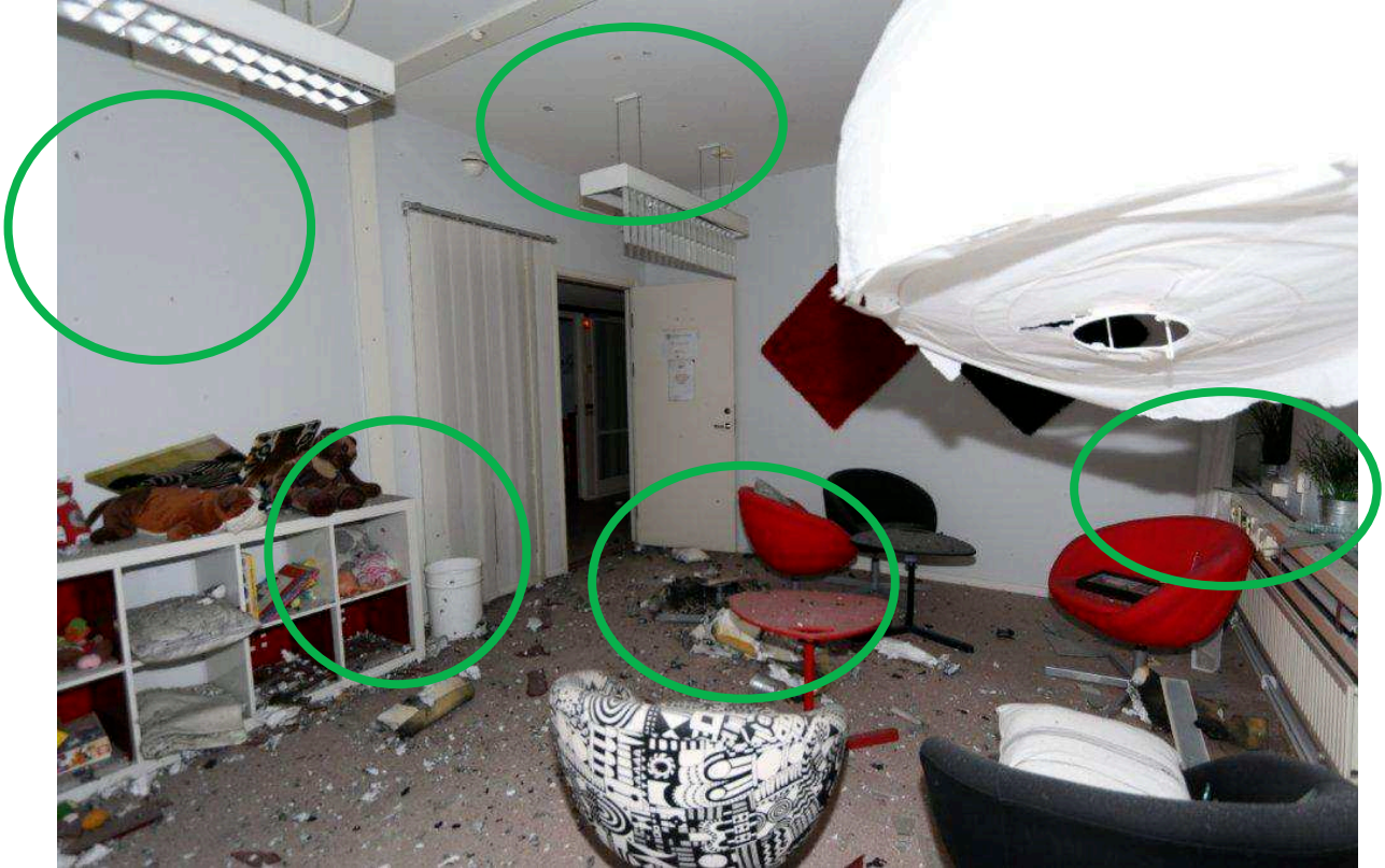
Bild 9 Visar exempel på verkan av handgranat av typ M50/M52 i byggnad.
