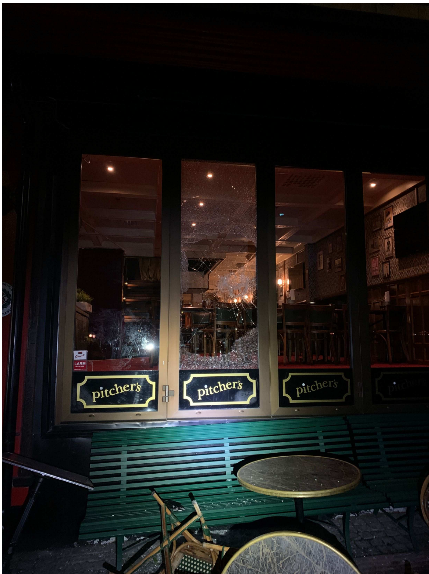
1. Bilder på skadegörelsen. Fönsterruta på pitchers. Bild av: Pa Klara Thorsén
